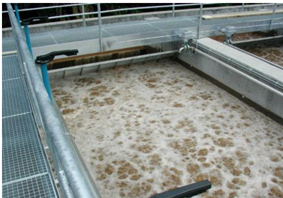
Rad biofiltracijske jedinice u toku aeracije
